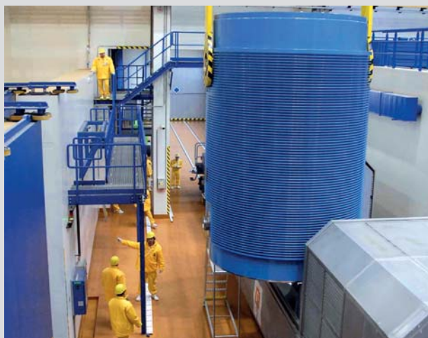
Skladovací kontejnery CASTOR v meziskladu použitého jaderného paliva v jaderné elektrárně Dukovany (Zdroj: ČEZ, foto: Jan Sucharda)
